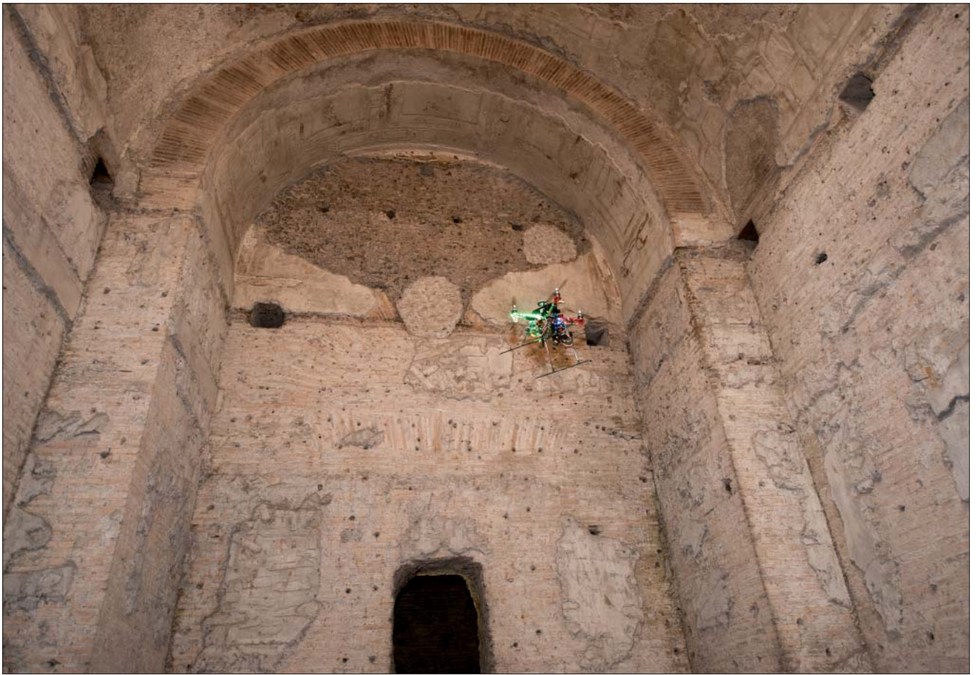
Figura 4 – (Mario Mazzoli – ASSO) Controllo di alcune aree interne della Domus Aurea a Roma Inspection of internal areas, inside Domus Aurea in Rome
